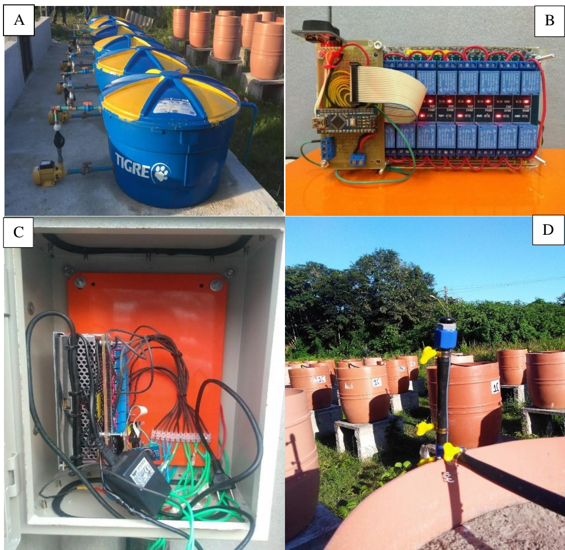
Figura 5. (A) Seis conjuntos de reservatório com capacidade de 500 L, filtro de disco e eletrobomba responsáveis pela distribuição das soluções salobras; (B) Controlador de válvulas solenoides composto por arduino com detalhe da distribuição dos conjunto de relés; (C) Painel de controle responsável por comandar a abertura e fechamento das válvulas solenoides; (D) Válvula antivácuo rosca ½”
