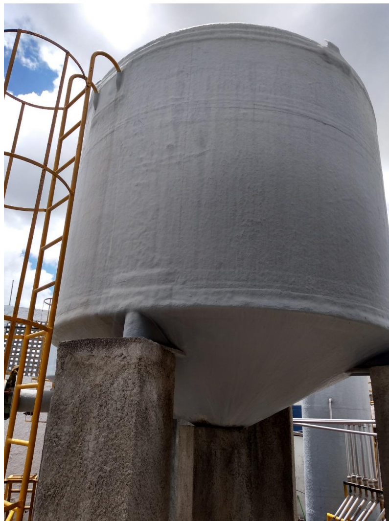
Figura 18. Decantador da Estação de Tratamento de Efluente da “Lavanderia X”.
