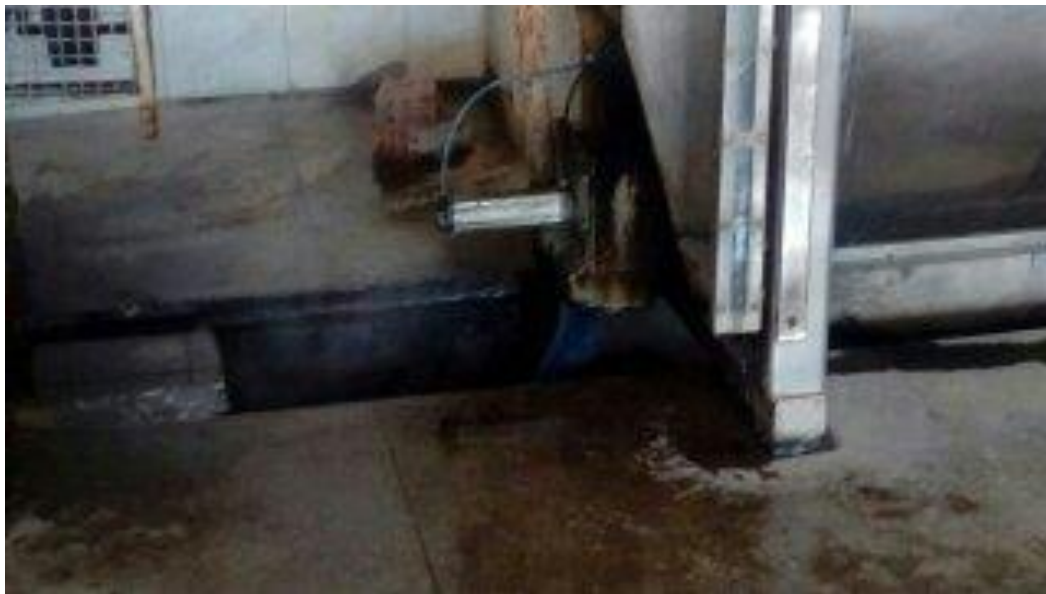
Figura 7. Valeta de captação do efluente bruto, localizada abaixo da máquina de lavar.
