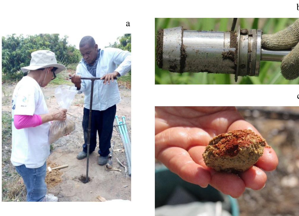
Figura 7. Procedimentos no campo para instalação dos poços de observação (PO) e amostragem de solo. a) tradagem para instalação dos poços b) coleta de amostras não deformadas c) identificação da presença de mosqueado.
