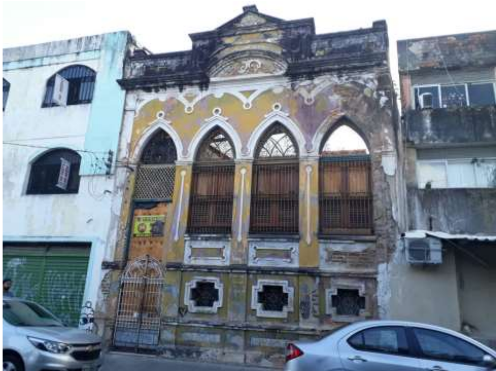
Figura 60 – Casa de porão alto com fachada eclética no nº 97 da Rua Largo de Santa Cruz, Boa Vista, Recife.
