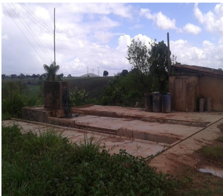
Figura 25. Dique de contenção de óleo combustível e separação de água e óleo
