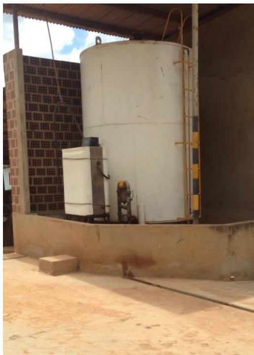
Figura 24. Sistema de contenção do efluente contaminado
