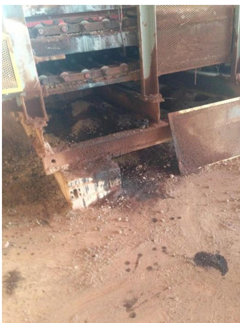
Figura 11. Indústria 1-Resíduo de óleo sem piso adequado
