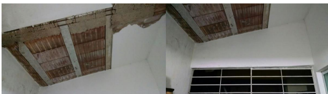
Foto 16: Parte do reboco do teto cedeu (Lajes expostas)
