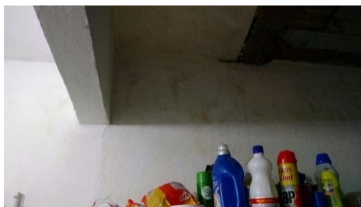
Foto 17: Infiltrações pela laje no teto
