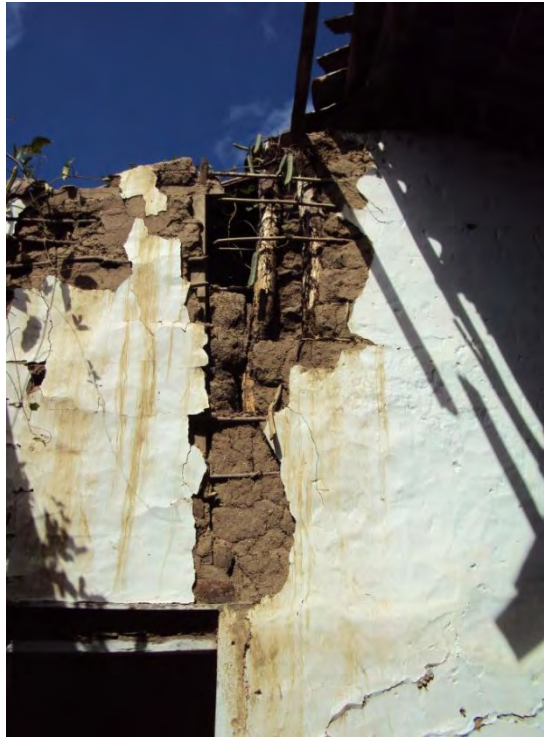
Foto 20 – Detalhe de lesão progressiva
