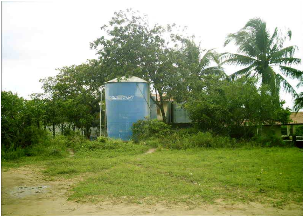
Foto 10: Caixa de Abastecimento de Água – Barra de Catuama - Goiana – Pernambuco SOTERO, 2008
