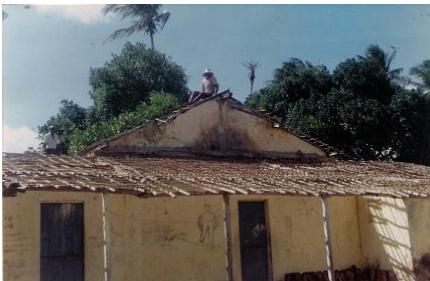
Fonte: Acervo do Ponto de Cultura Estrela de Ouro de Aliança. Figura 11: Situação em que se encontrava a casa de Chã de Câmara.
