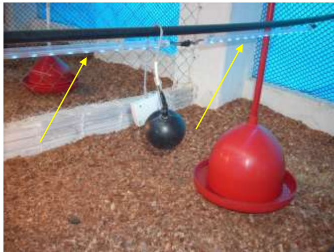
Figura 8 – Lâmpadas de LED tipo bastão, fixadas longitudinalmente no centro geométrico de cada box de produção.
