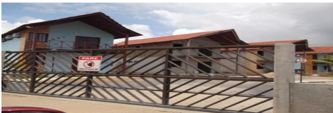
Imagem 05. Construção de casas em uma área de mangue na Praia dos Carneiros.
