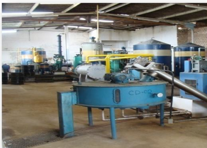
Figura 07- Instalações da usina Gov. Miguel Arraes. Fonte: Levantamento de campo
