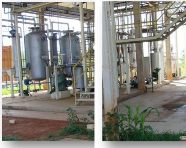
Figura 08- Usina de Serrote Redondo . Fonte: Levantamento de Campo
