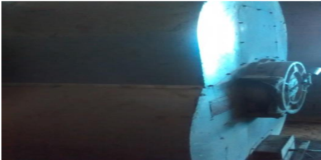
Fotografia 10 – Caldeira utilizada no aquecimento de galpão avícola em Bonito-PE
