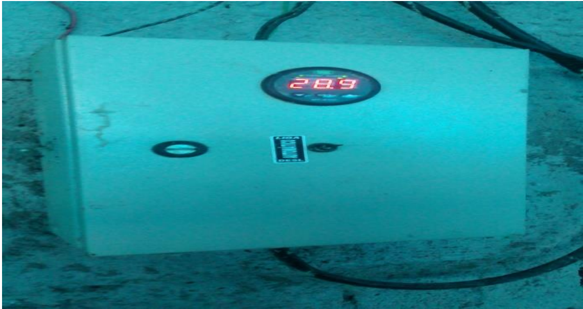
Fotografia 11 – Controle de temperatura realizado por caldeira de galpão avícola em Bonito-PE
