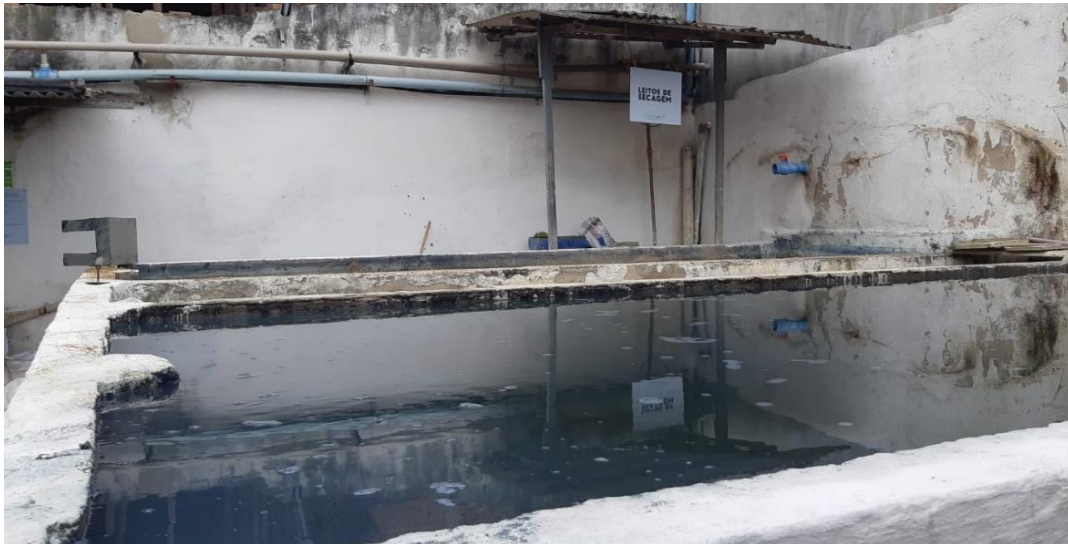
Figura 15: Leitos de Secagem da “ETE Y”
