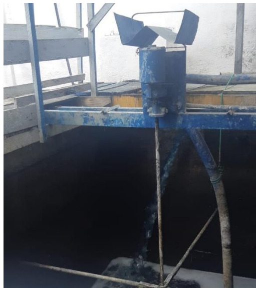
Figura 14: Entrada do efluente bruto na ETE da “lavanderia Y”
