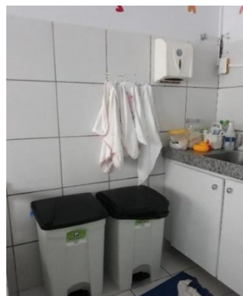
Zona do banho e troca de roupa/fralda
