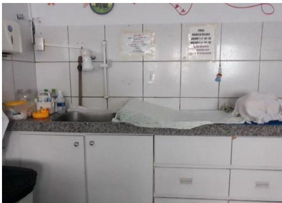
Zona do banho e troca de roupa/fralda
