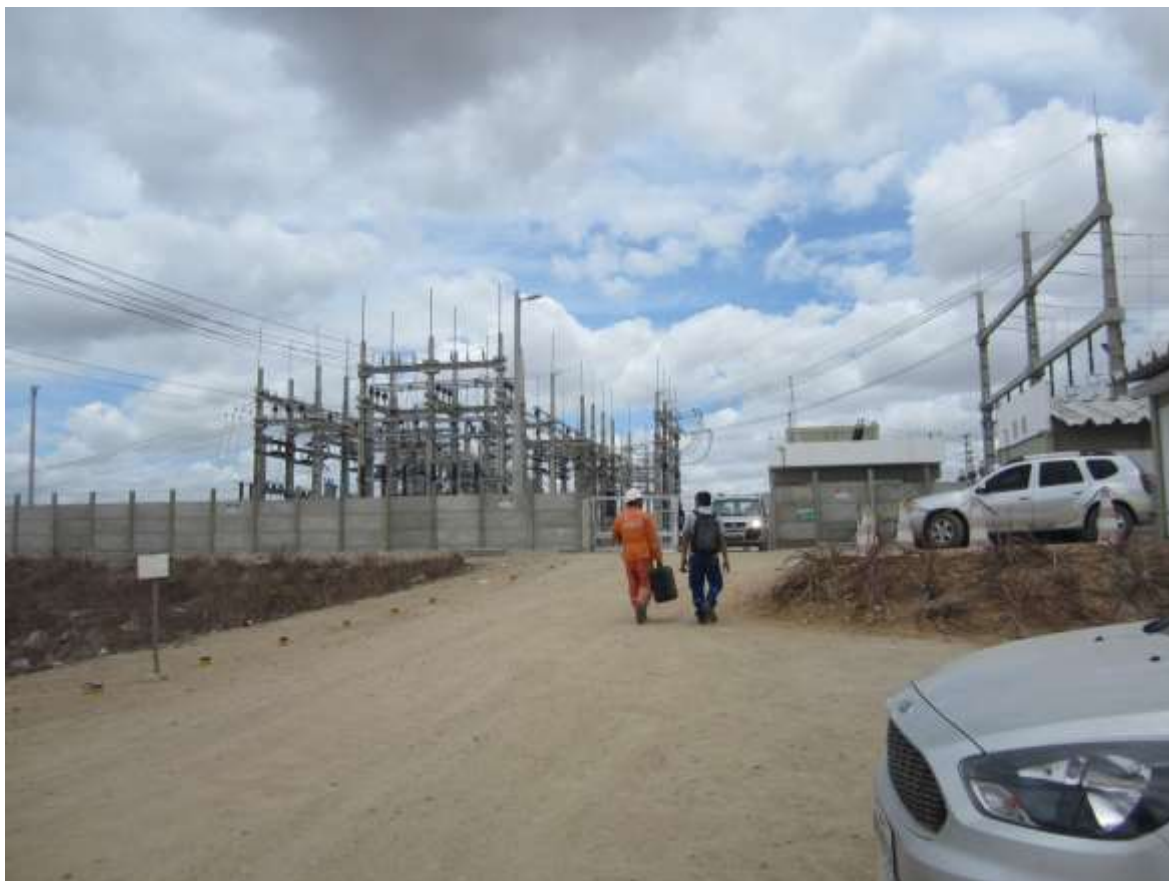
Figura 11. Entrada da Subestação.
