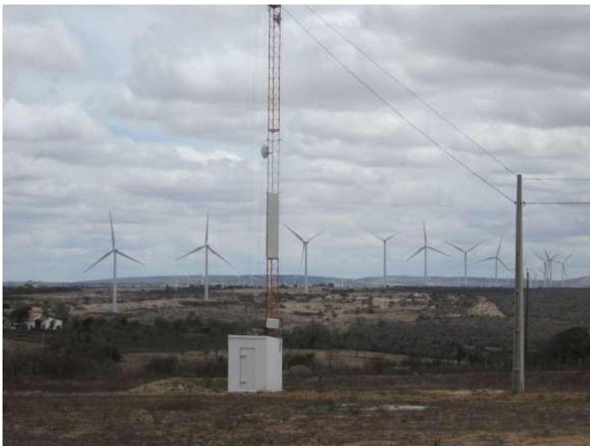
Figura 7. Torres de comando dos aerogeradores.
