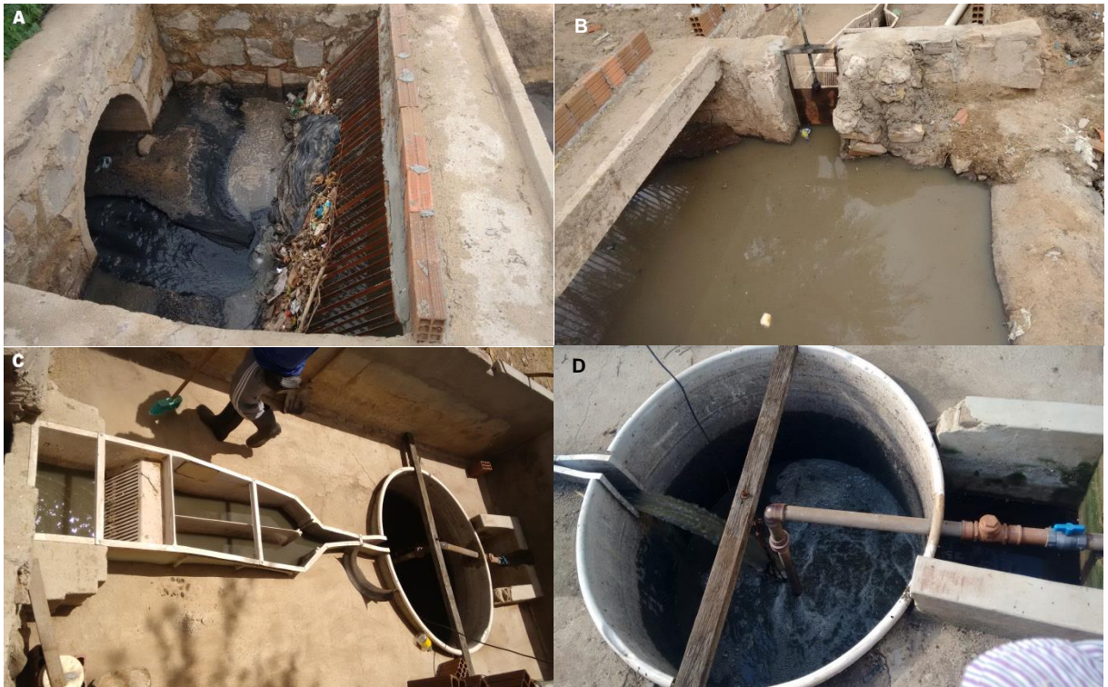
Figura 4 – Detalhe do sistema de pré-tratamento integrado pela grade de barras de ferro (A), barragem de sedimentação (B), caixa de areia + calha Parshall (C) e poço úmido (D)
