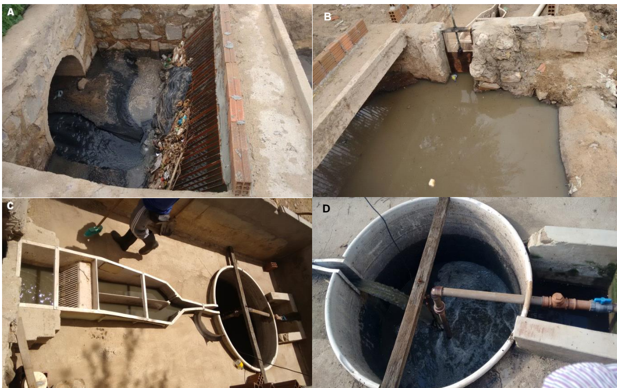
Figura 4 – Detalhe do sistema de pré-tratamento integrado pela grade de barras de ferro (A), barragem de sedimentação (B), caixa de areia + calha Parshall (C) e poço úmido (D)
