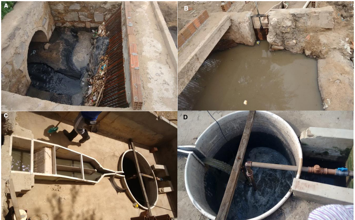
Figura 4 – Detalhe do sistema de pré-tratamento integrado pela grade de barras de ferro (A), barragem de sedimentação (B), caixa de areia + calha Parshall (C) e poço úmido (D)
