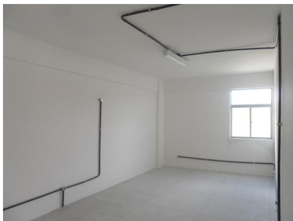
Figura 33 - Residência Estudantil: climatização apenas onde necessária e uso exclusivo de lâmpadas fluorescentes
