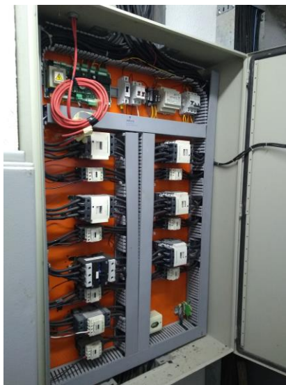
Figura 13 - Biologia: equipamento de automação da iluminação
