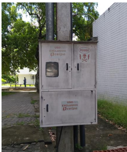
Figura 14 - Biologia: sistema de medição individualizado de consumo de energia
