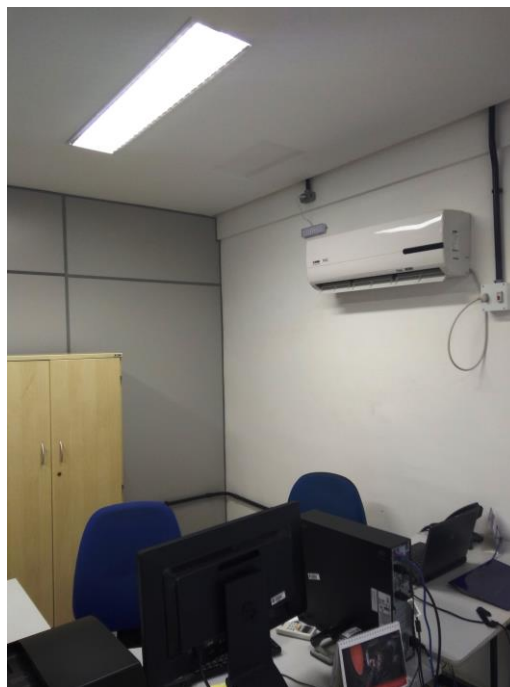
Figura 31- Central de descartes: climatização apenas onde necessária e uso exclusivo de lâmpadas fluorescentes
