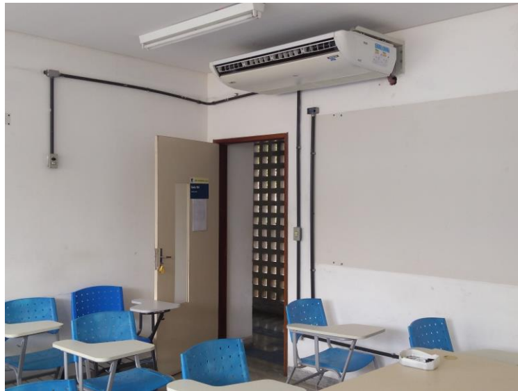
Figura 10 - CEGEN: climatização apenas onde necessária e uso exclusivo de lâmpadas fluorescentes
