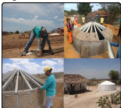
Figura I: Cisternas de Placas
