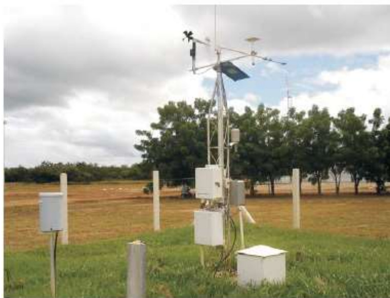
Figura 04: Estação Agrometeorológica Automática instalada na Fazenda Brasil Uvas, em Juazeiro – BA. Fonte: Embrapa Semiárido, 2015
