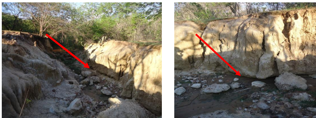
Figura 40. Processo de erosão lateral na voçoroca Caiçara, Serra Talhada- PE, conforme previsto pelo modelo de Foster & Lane (1983)
