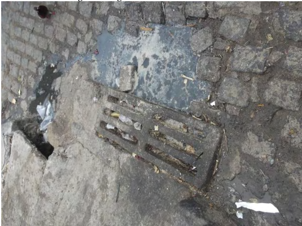
Imagem 14: esgoto na feira livre do Cordeiro
